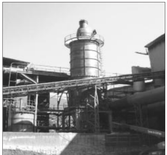
Fig. 12 – Torre di Quenching.
